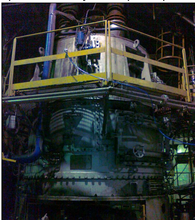
Młyn węglowy MKM-25 wraz instalacją inertyzacji
