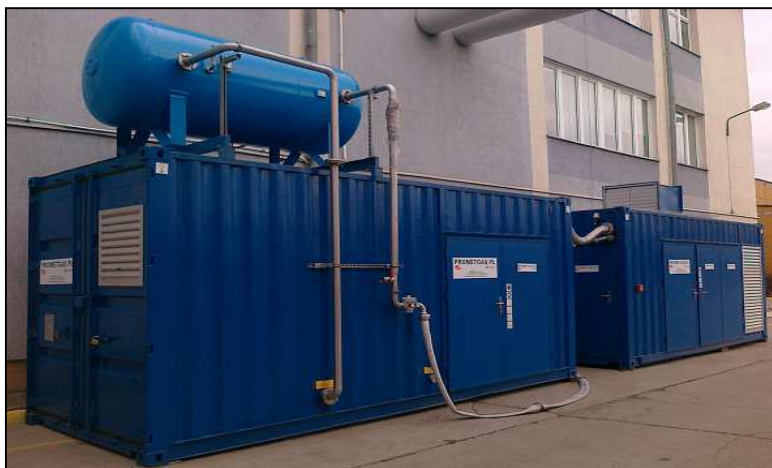
Membranowy generator azotu MGA-600-97 na terenie KOGENERACJA S.A.
