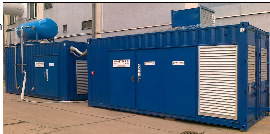
Próby w KOGENERACJA S.A. membranowego generatora azotu MGA-600-97
