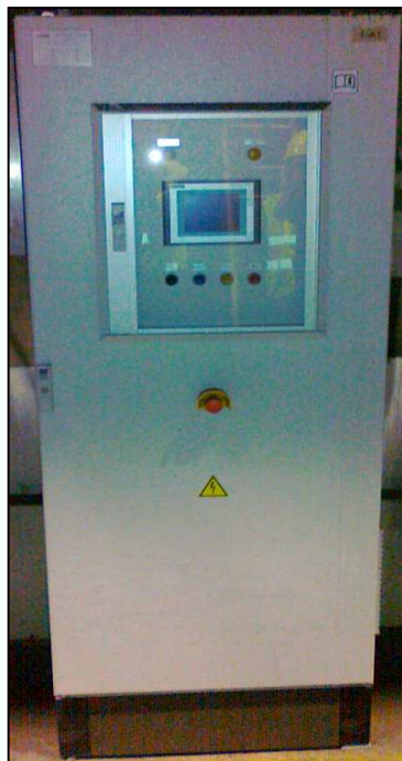
Szafa sterownicza systemu prototypu inertyzacji
